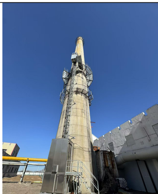
65m 高排气筒 (DA001)
