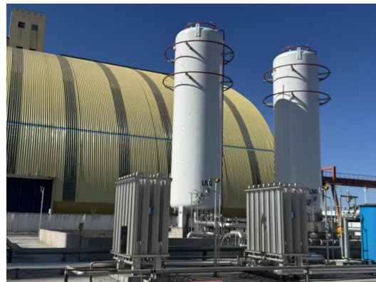
2 台 50m 3 LNG 立式储罐
