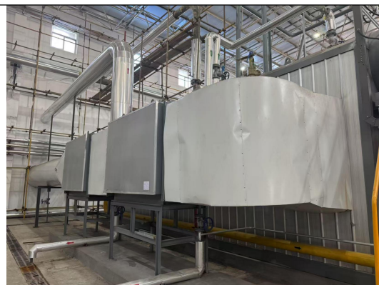
部分烟气再次燃烧系统
