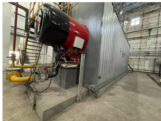
燃气锅炉基础减振、隔声
