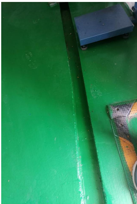
危废库导流槽
