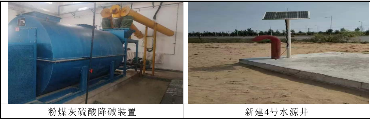
图 3.3-1 降碱装置及水源监测井实际建设情况
