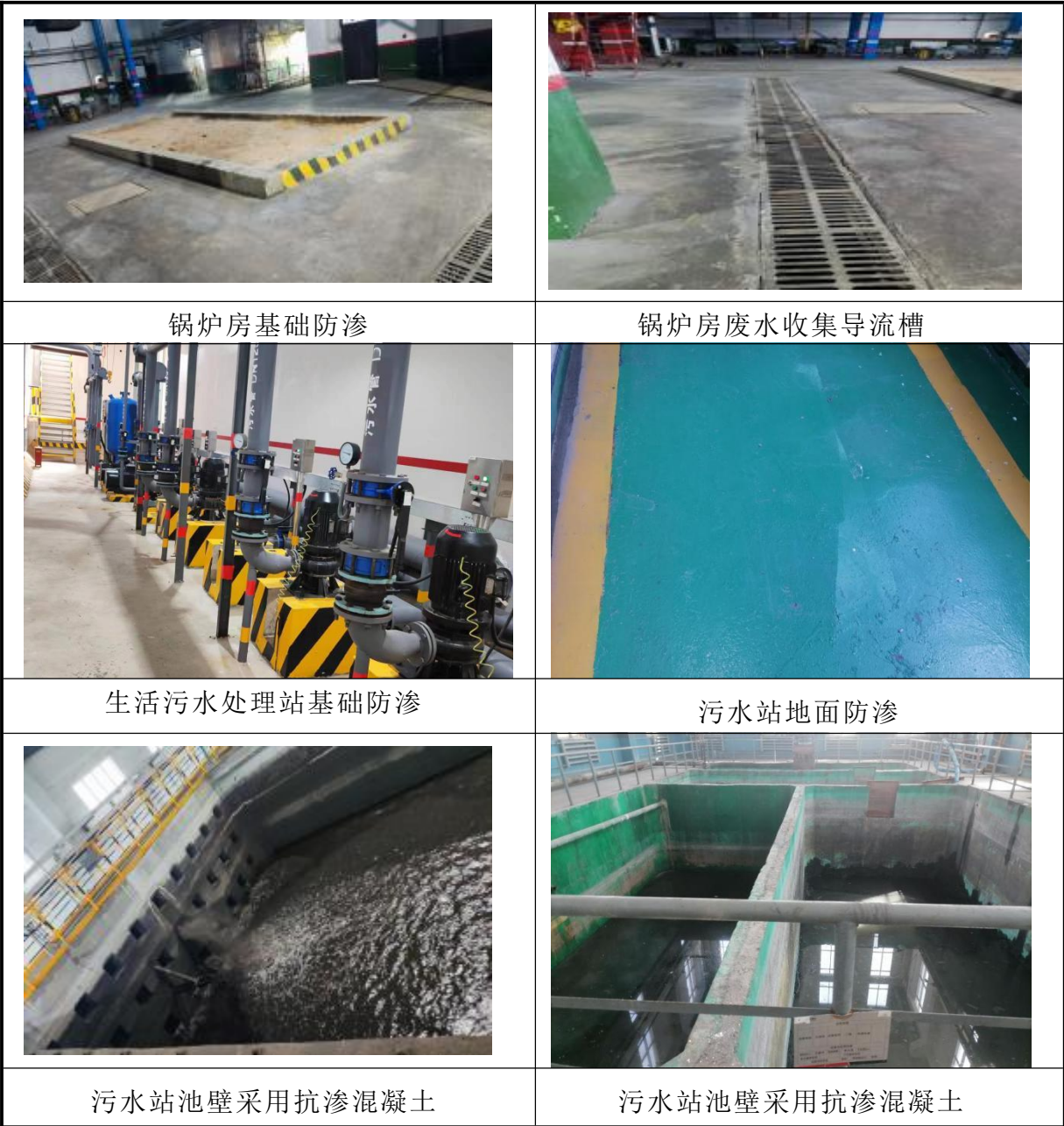
图 6.2-1 地下水防治措施及设施实际建设情况
