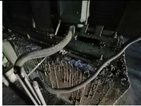
锅炉房鼓风机消音器及减震
